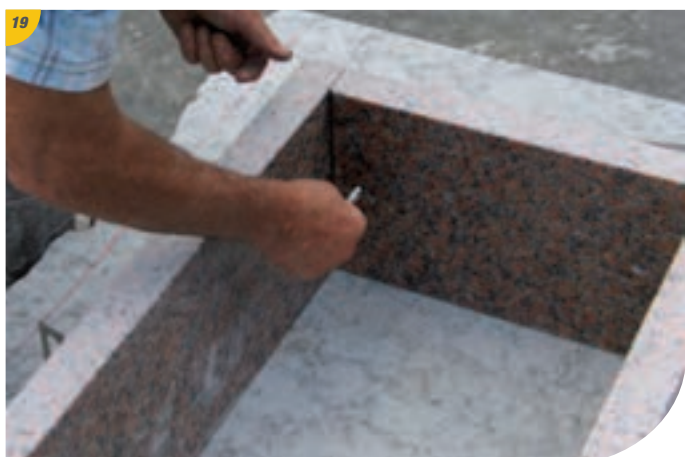
19 Se munir d'équerres, de chevilles, de rondelles et d'un marteau pour fixer la rehausse. Taper assez fortement sur les chevilles pour qu'elles s'écartent dans la pierre.
